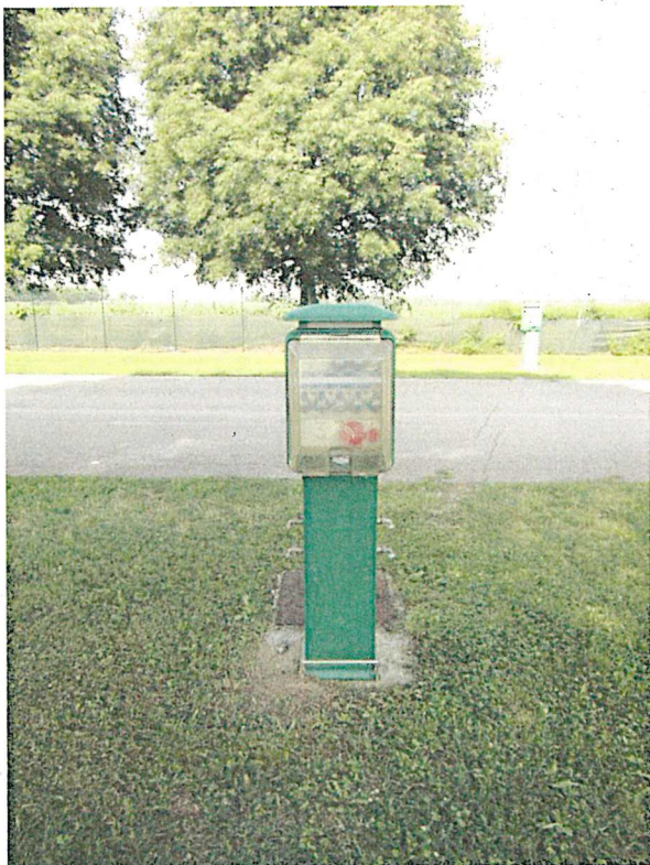
Colonnine per l'approvvigionamento idrico ed elettrico in dotazione presso l'area
