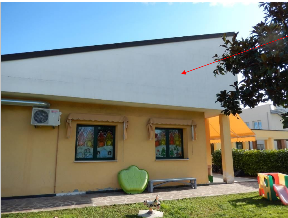
Figura 95: pareti di tamponamento vulnerabili
